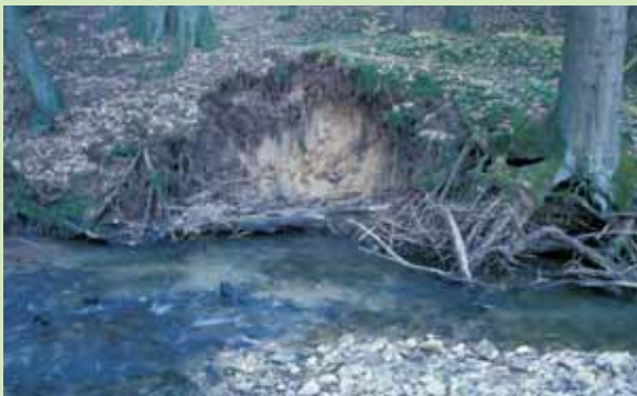
Bild 21: Sind die Ufer unbefestigt, können natürliche Uferabbrüche entstehen.
